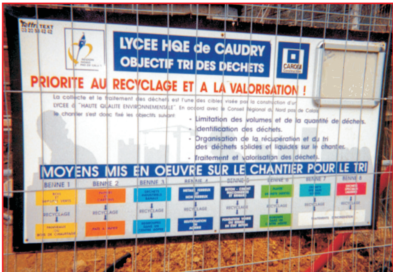
2 Exemple d'un panneau de chantier sur les moyens mis en œuvre pour le tri des déchets (PUCA - Plan Urbanisme Construction Architecture).
