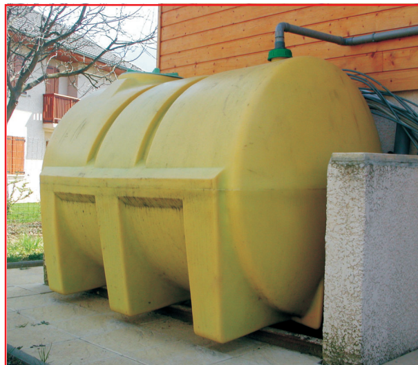
Citerne de récupération des eaux de pluie 1 pour arrosage des espaces verts.
