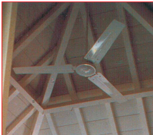
Ventilateur de plafond. Saint-Denis (La Réunion) (arch. G Torcatis).
