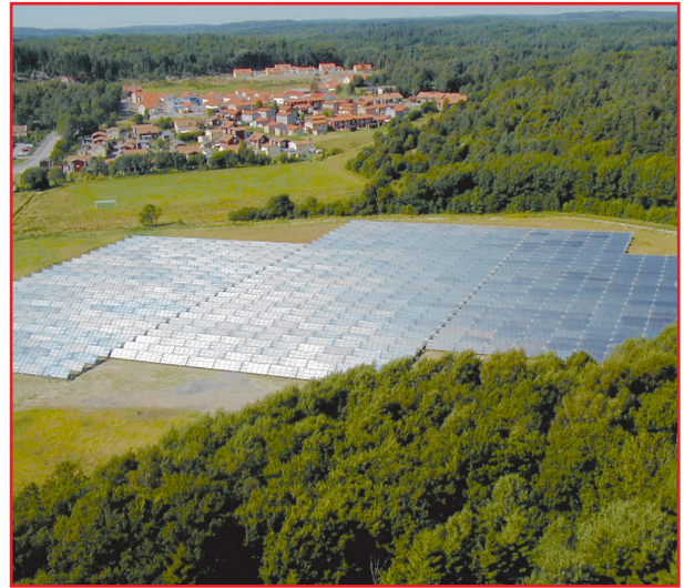
1 Le réseau de chaleur de Kungälv (Suède) alimenté, en partie, par les 10 000 m 2 de capteurs solaires thermiques.
