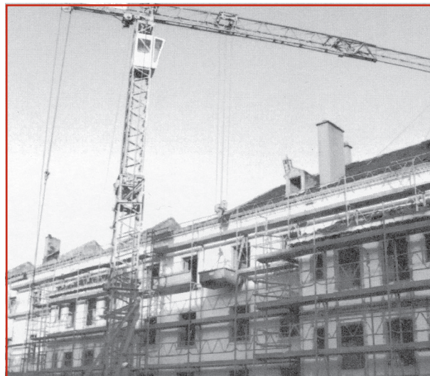
1 Déconstruction sélective d'un bâtiment (Mulhouse) (IFARE - Institut Franco-Allemand de Recherche sur l'environnement).
