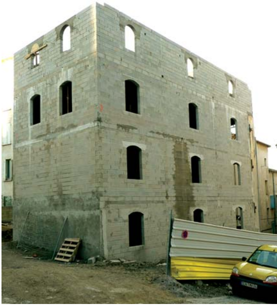
L'immeuble Blanc-Barth en chantier : nouvelles façades sur la place aux OEufs et la place du Palais
