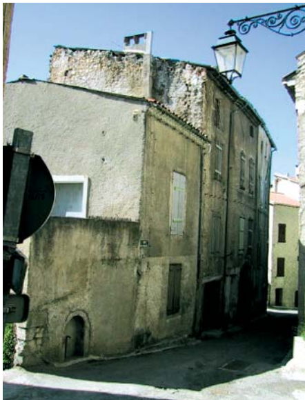
Les immeubles très dégradés bordant la rue du Palais
