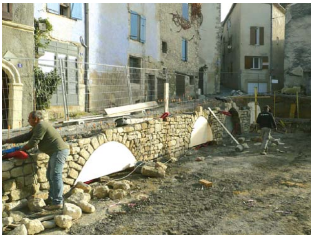
Les maçonneries en pierre de taille, le long de la rue du Palais.
