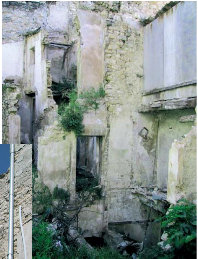
En cœur de l'îlot, des parties déjà ruinées...
