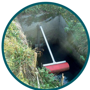
Régulateur sur flotteur la Quérillière • Saint-Just Saint-Rambert
