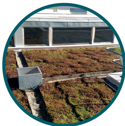
Toitures végétalisées Loire Forez agglomération • Montbrison
