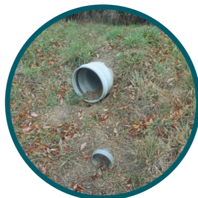
Ajutage cylindrique bassin de rétention aérien au Cluzel • Lézigneux
