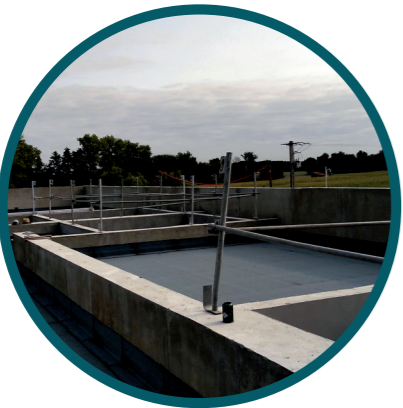
Toitures stockantes station d'épuration • Saint-Marcellin-en-Forez
