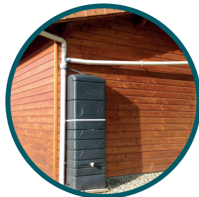
Cuve hors-sol • Vinols • Bard
