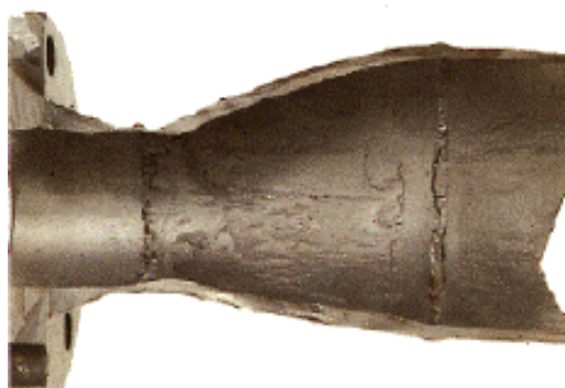
Corrosion-érosion dans une zone turbulente
